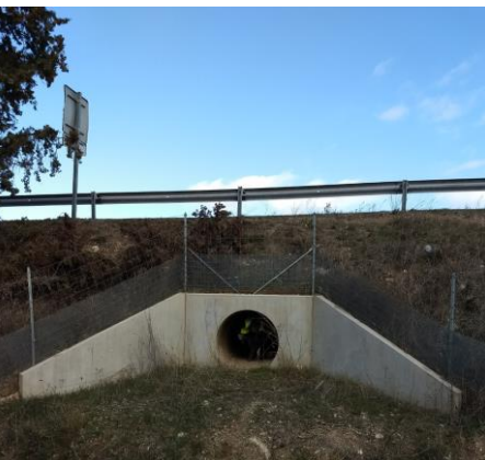
Entrée de l'écoduc sous l'autoroute A7 dans le bocage du pays salonnais © Aurélie Johanet
